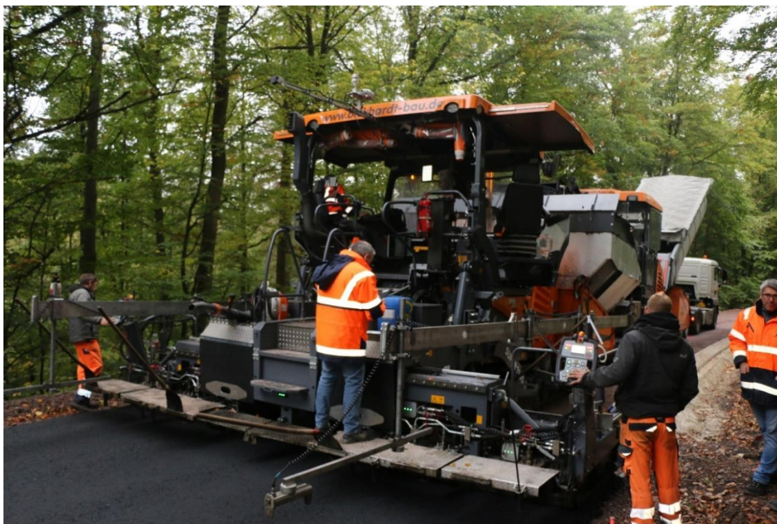
Quelle: Bickhardt Bau AG – Einbau von Temperaturabgesenkten Asphalt mittels Straßenfertiger mit Absauganlage
