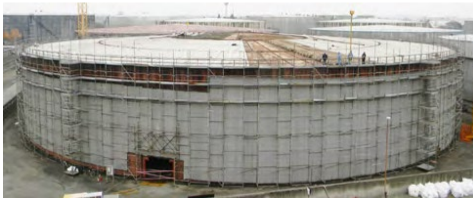
Bild 11: Unisoliertes Tankdach vor der Sanierung 1
