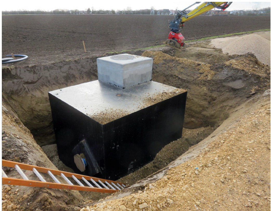
Abb. 3: Die Baugrube ist mit dem digitalen Baugrubenassistenten hergestellt worden. Mit seiner Hilfe lassen sich die Größe der Grube, der Aushub und der Böschungswinkel berechnen. So entsteht weniger Aushub und Lkw-Fahrten werden reduziert.
