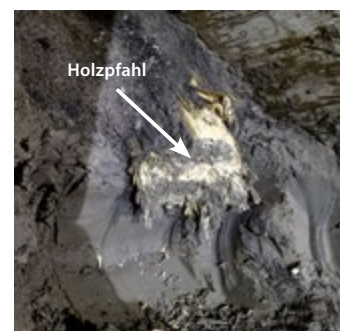
Abbildung 23: Vortrieb DA 2700, künstliches Hindernis senkrechter Holzpfehl durchlaufend durch gesamten Aus- bruchquerschnitt, Durchmesser 40 cm
