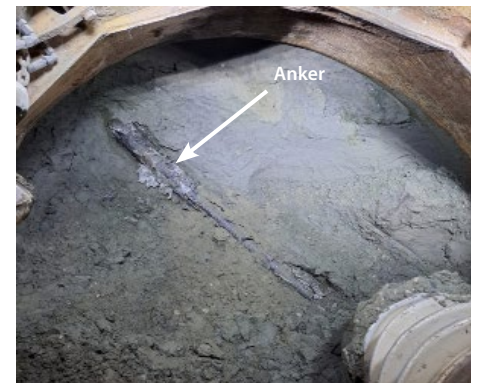
Abbildung 19: Anker als Hindernis in DA 2240
