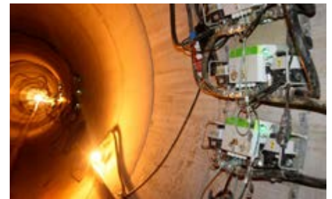
Abbildung 6: Automatische Bentonitschmieranlage (Quelle: Max Bögl)
